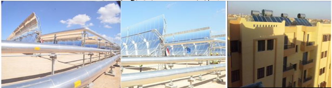
شكل رقم (٩٦) محطة CSP المقامة بمدينة برج العرب الجديدة
